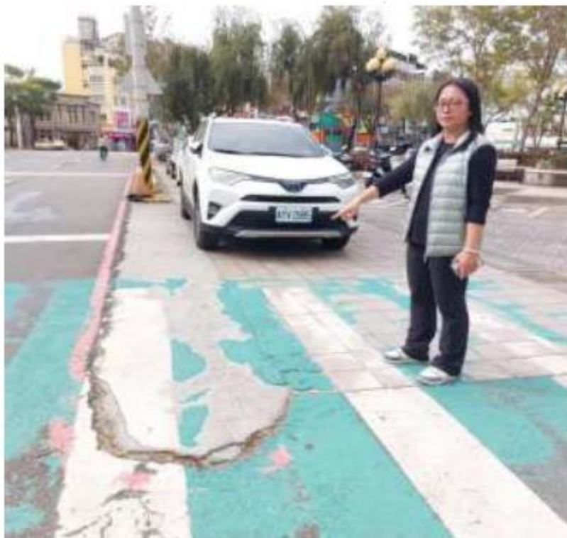
避車彎安全島已拆除部份，尚有部份突出路面
