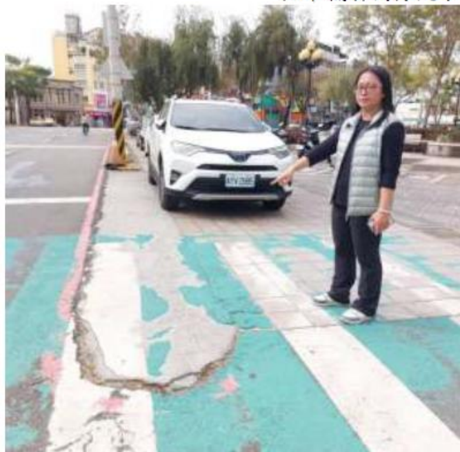
避車彎安全島已拆除部份，尚有部份突出路面
