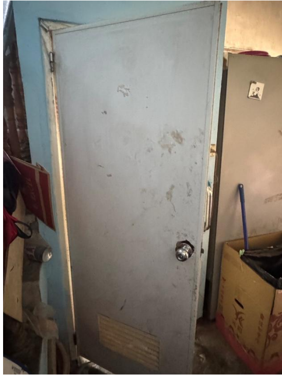
清水區案施工前:廁所門損壞。
