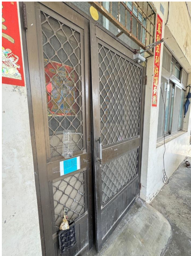
清水區案施工前:大門門檻高低差造成輪椅出入困難及鋁門窗損壞無法闔上。
