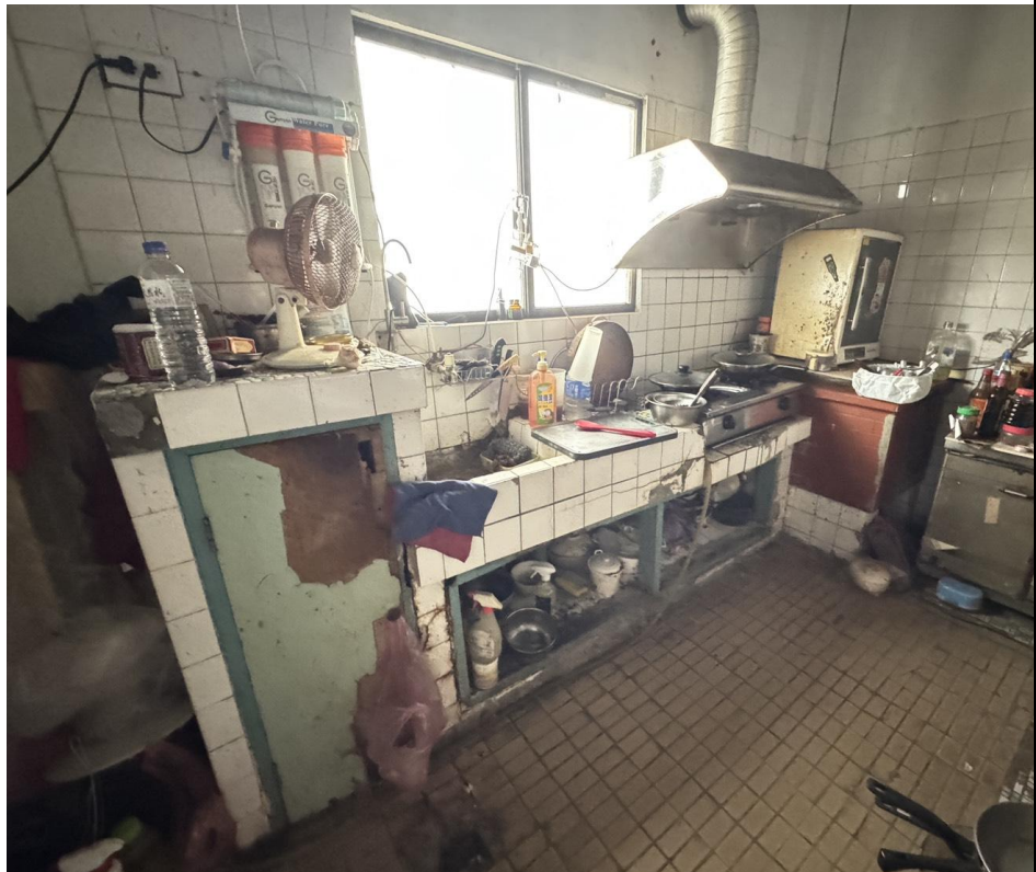
梧棲區案施工前：申請人廚房老舊設備不堪使用。
