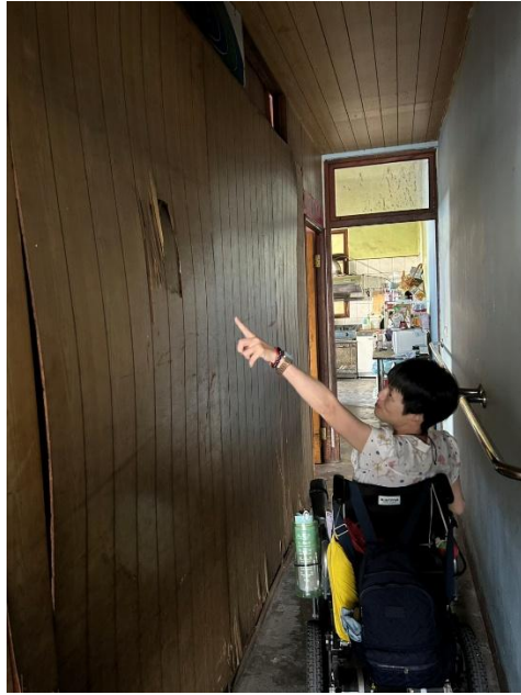
清水區案施工前:房間及走道木板隔間損壞。
