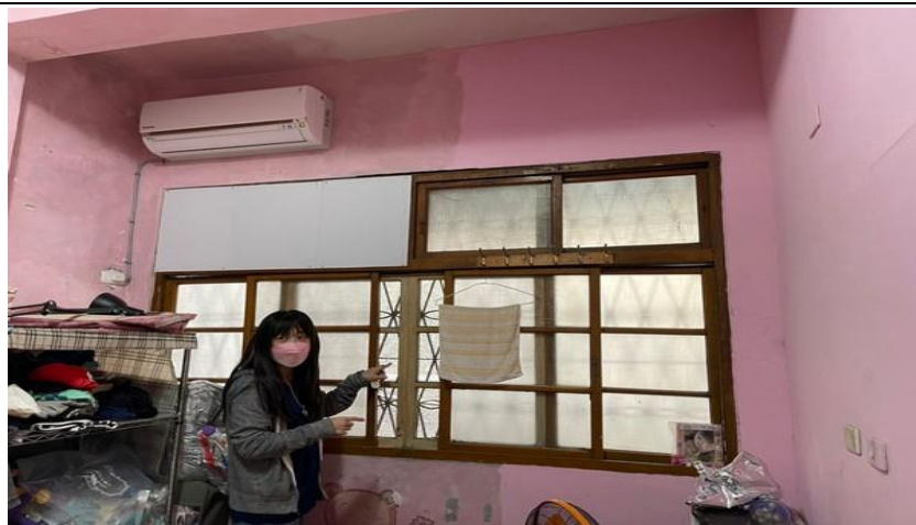
施工前:鐵窗因年久損壞多年，每逢遇強風豪雨，門窗會產生巨大聲響或滲水
